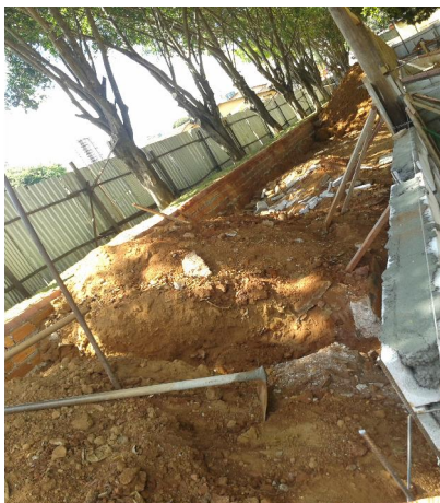
Figura 06: aterro para o nivelamento da calçada no Parque Ipiranga, Bairro Jundiá. Fonte: Ramos 2013
