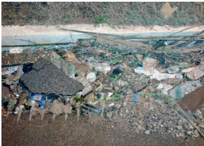
Figura 04: bueiro entupido após a chuva nas imediações do Parque Ipiranga, Bairro Jundiá. Fonte: Ramos 2014
