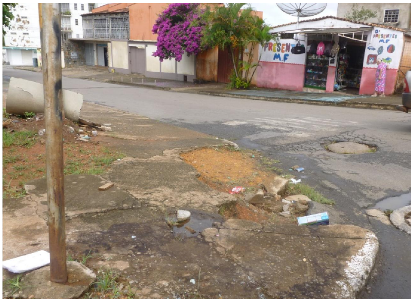
Figura 01: calçada danificada na Av. Anderson Cleiton na Vila Formosa. Fonte: Ramos 2014
