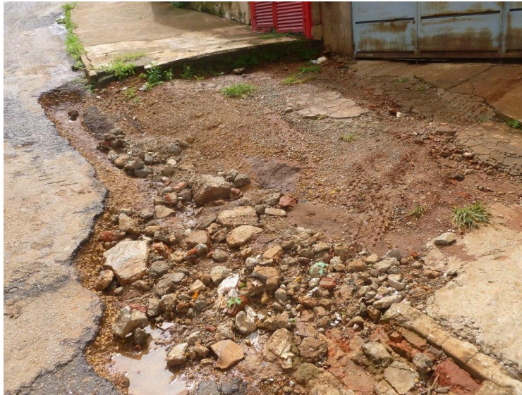
Figura 03: Calçada danificada pela chuva na Rua Serapião Ribeiro, Vila São José. Fonte: Ramos 2014
