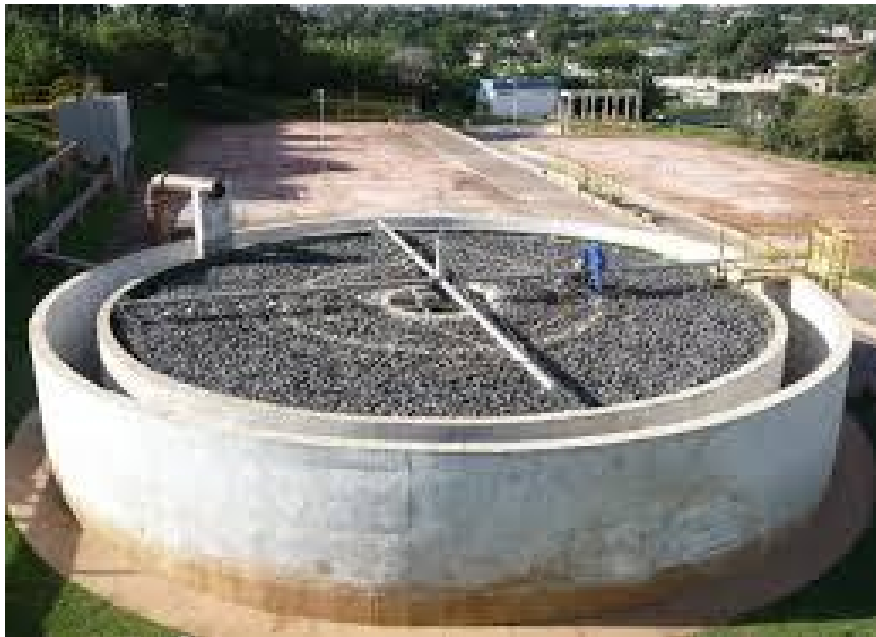
Figura 3: Filtros Biológicos para Tratamento de Esgoto
