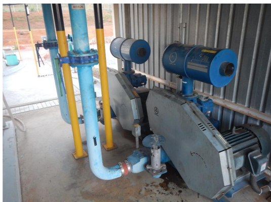
Figura 8: Sopradores Fonte: DO AUTOR
