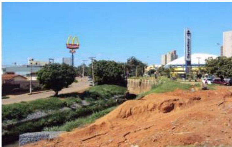
Figura 04: Avenida Brasil próximo ao Brasil Park Shopping. A obra de contenção foi realizada pela Prefeitura Municipal, mas não foi suficiente, pois a técnica usada (gabiões) não suportou o escoamento das águas e veio a desabar. Fonte: PMDU (2013).
