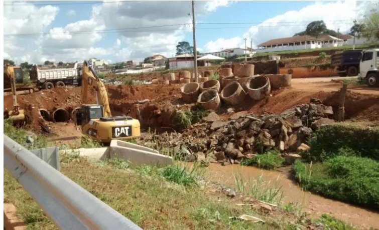
Figura 05: Avenida José Sarney em obras. Nesta região as obras estão em andamento, com previsão de término para antes do período chuvoso.
