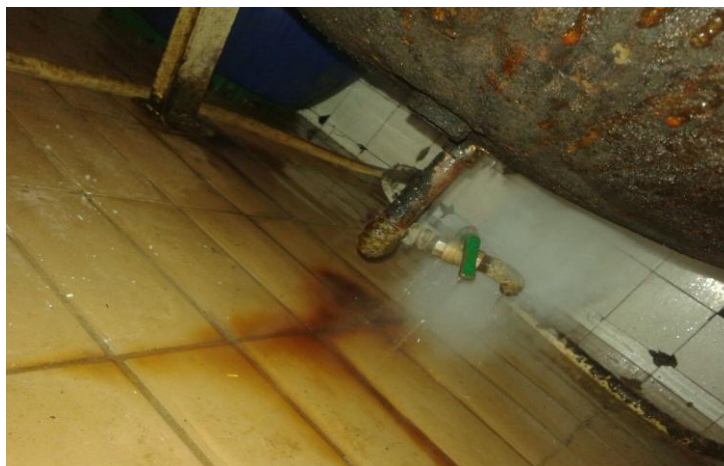
Figura 1. Vazamento na saída de vapor dos tachos.
