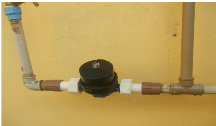
Figura 3. Medidor de Vazão.
