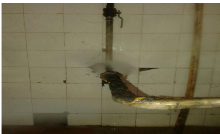
Figura 2. Vazamento na entrada de vapor dos tachos.
