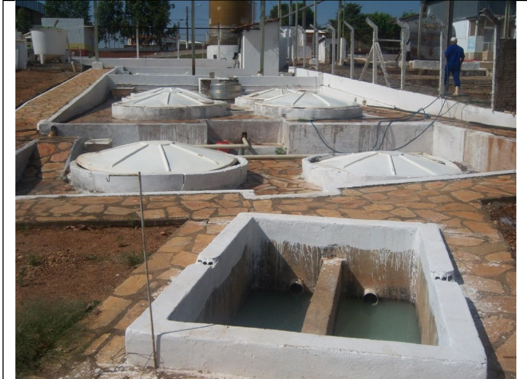
Figura04 – Vista geral da Estação de Tratamento de Efluentes (ETE) do laticínio Fonte: Ferreira (2013)
