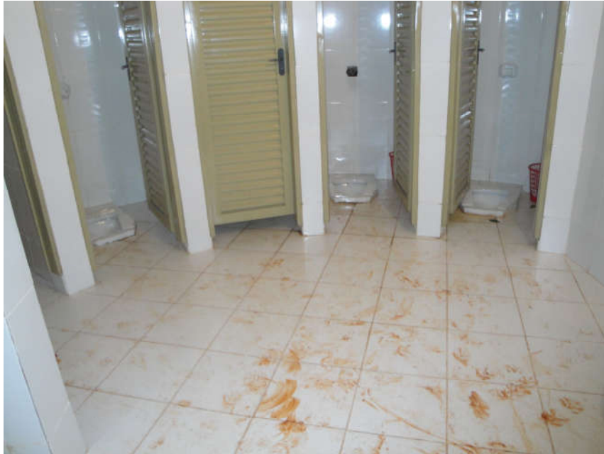
Figura 6 – Banheiros sem manutenção
