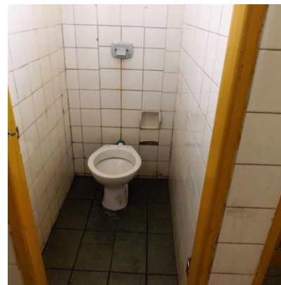
Figura 13 – Banheiro sem porta
