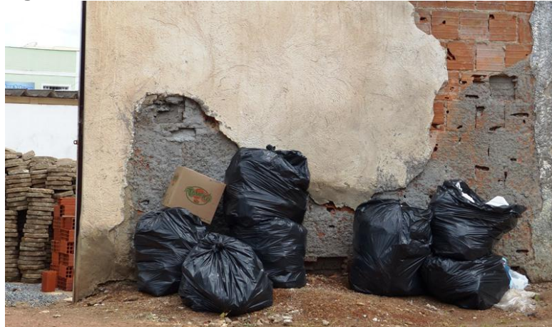
Figura 6 – Escola com área utilizada para entulho.
