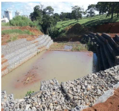
Figura 15: Gabiões para conter o processo erosivo ocorrido por meio de lançamento a meia Vertente de galeria pluvial
