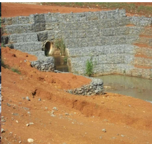
Figura 16: Gabiões para conter o processo erosivo ocorrido por meio de lançamento a meia Vertente
