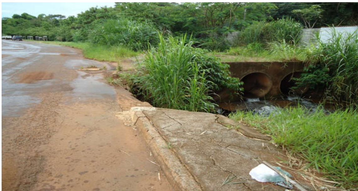
Figura 4- Calçada danificada por movimento de massa
