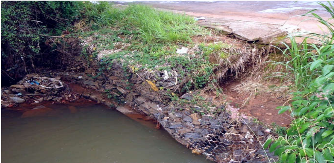
Figura 05 - Gabião armado danificado
