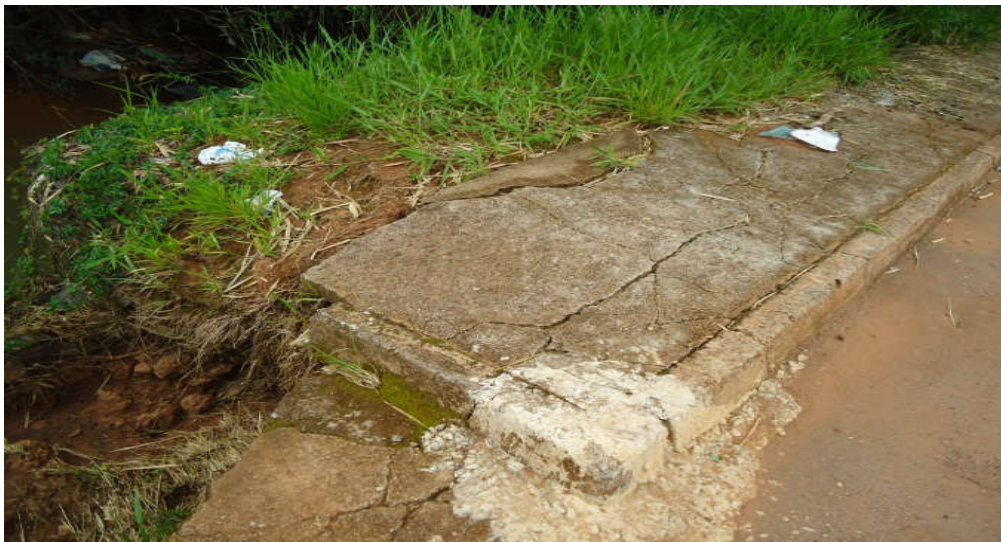
Figura 3- Registro das rachaduras provocadas por movimento de massa nas margens do córrego Água Fria – Anápolis-GO
