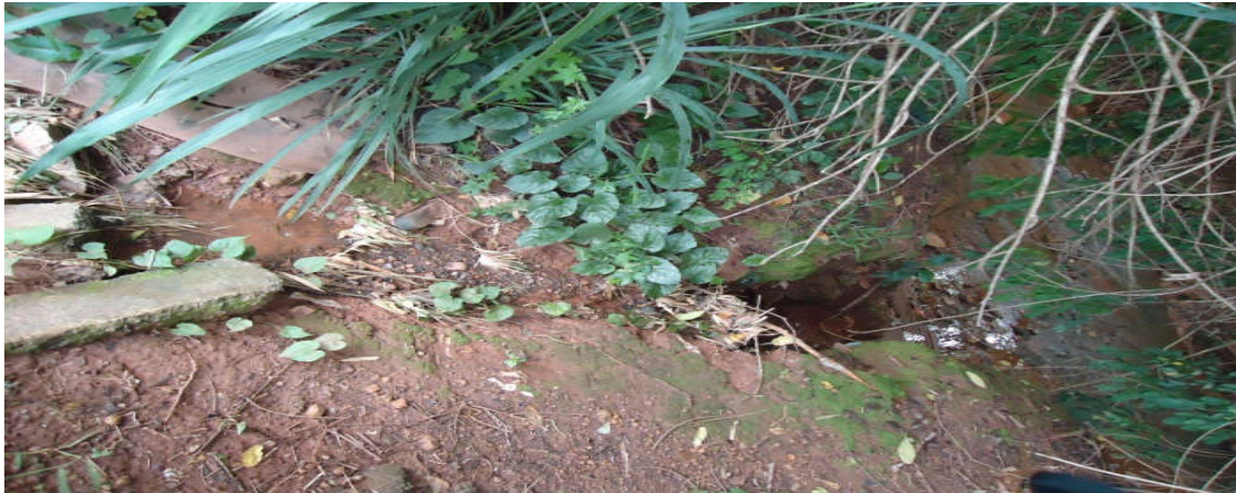
Figura 6 - Erosão, sistema de captação de águas pluviais
