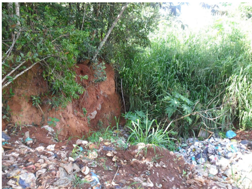
Figura 4 - Erosão caracterizada por sulcos no lixão do município de Campo Limpo de Goiás.
