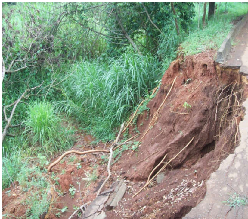
Figura 04- Processo erosivo no Parque.
