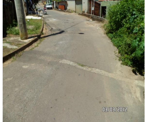
Figura 9: Quebra do asfalto para ligação clandestina de esgoto.
