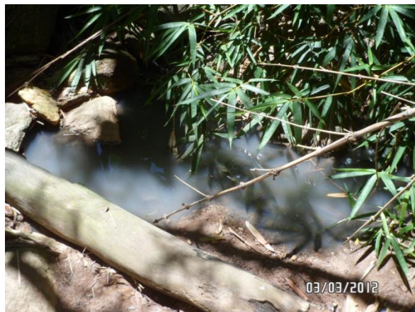
Figura 13: Esgoto que sai da rede pluvial
