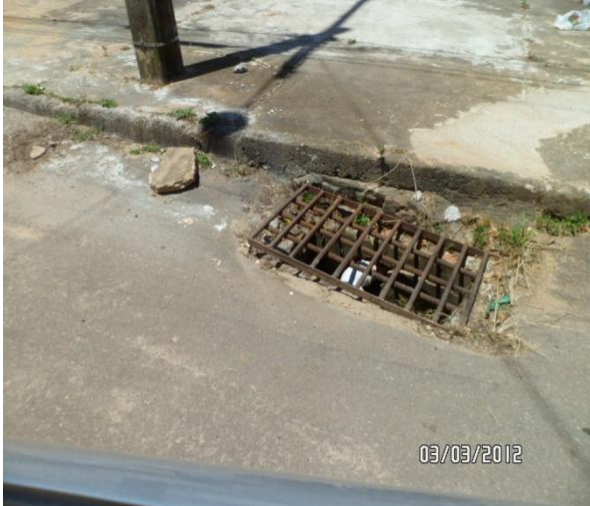
Figura 8: Ligação clandestina de esgoto.
